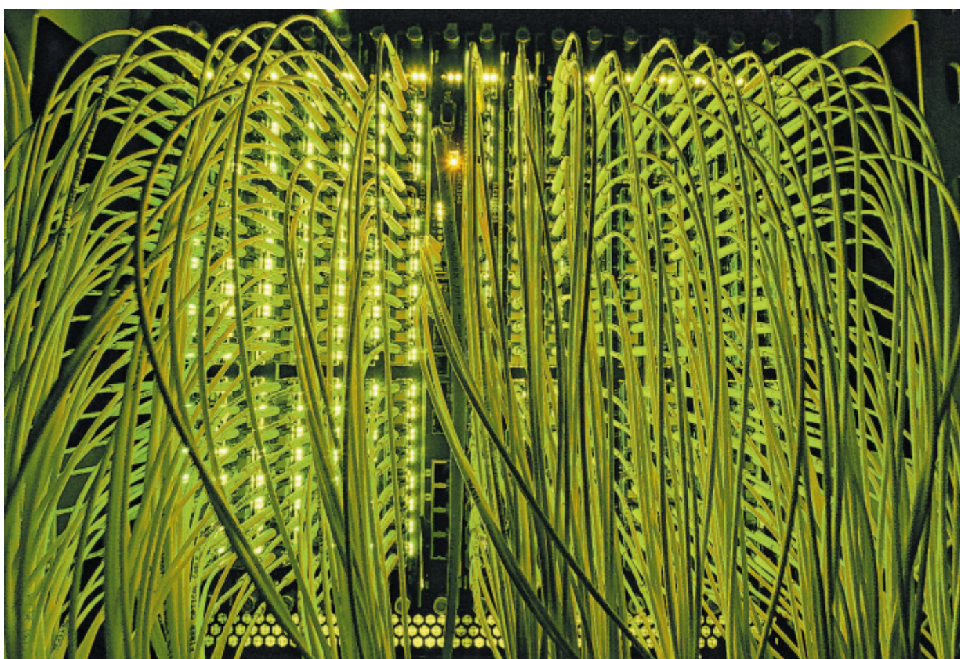
Schnell im Netz: In Rheda-Wiedenbrück wurde 2016 das Telekom-Netz um 42 Kilometer Glasfaser verlängert. 19.200 Haushalte können mit Internet bis zu 100 Mbit/s versorgt werden. Die Unterversorgung in Randbereichen soll 2018 behoben werden, informiert das Rathaus. FOTO: DPA
